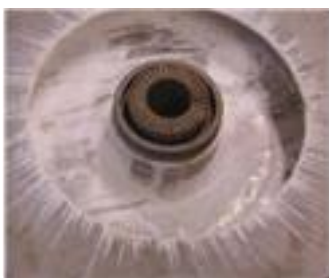
zaprljane i korodirane prskalice
